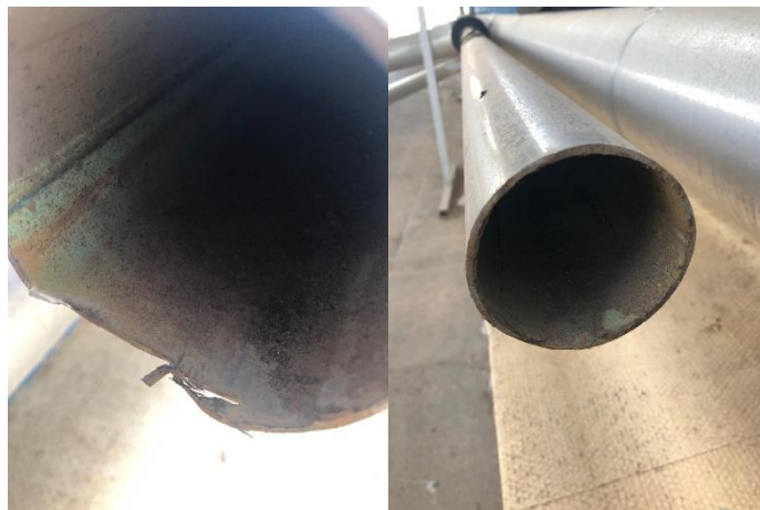
Corrosión en las tuberías de la instalación del circuito solar
