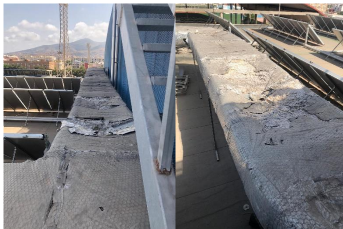
Conducto de retorno de ventilación deshumectadora
