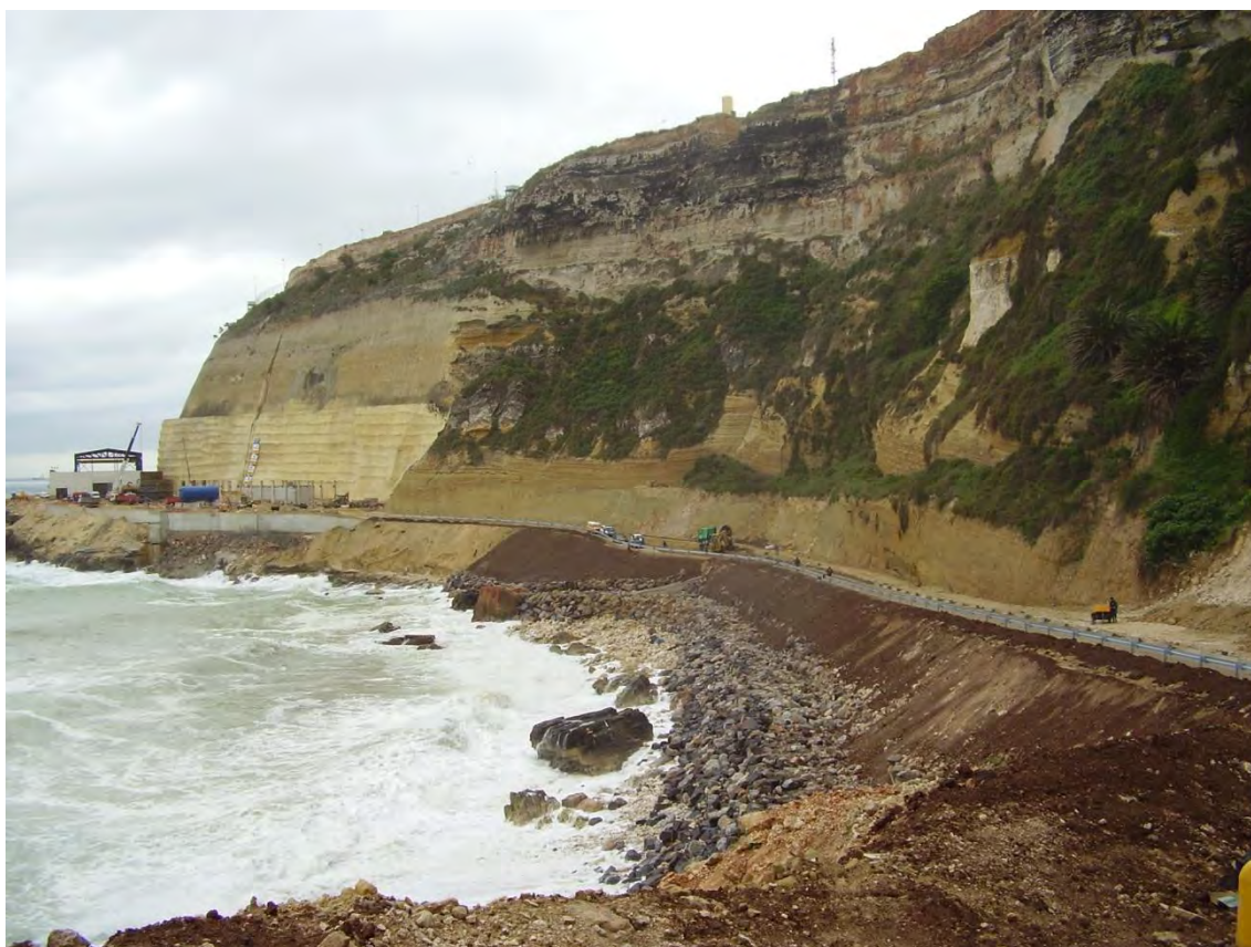
Figura 34. Litoral de la ZEC con la desalinizadora y la carretera en construcción
