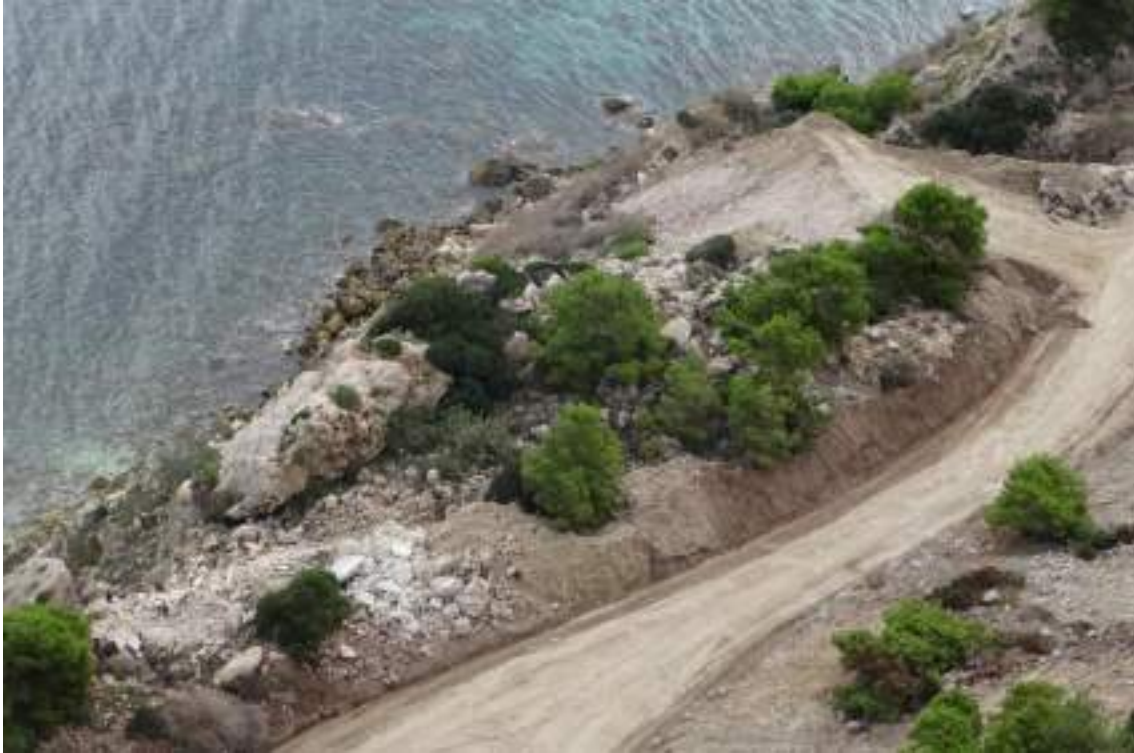
Agresiones en parte de la subzona 2.B durante las obras
