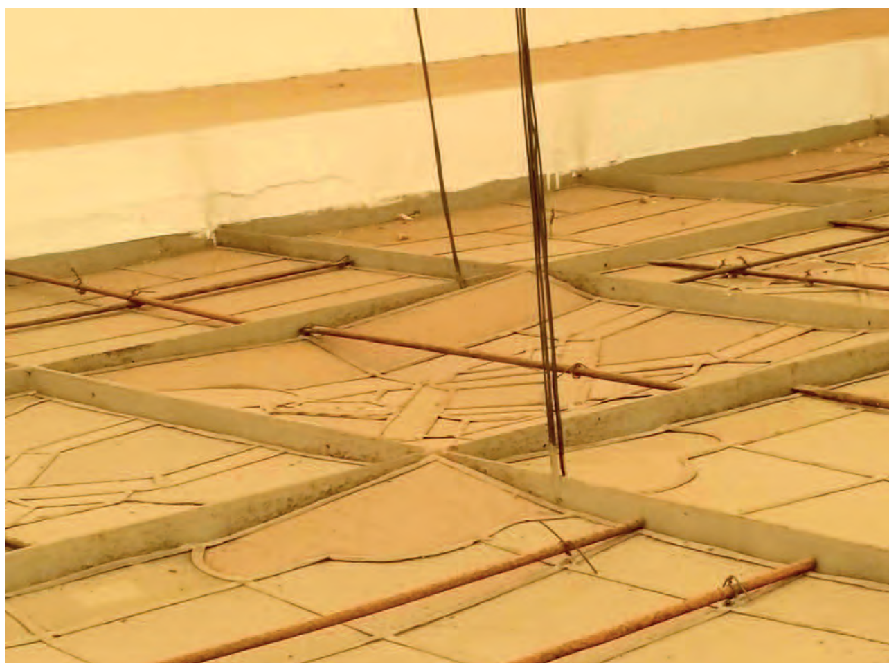
(Figura 1) Detalle, paneles de la cúpula antes de la intervención.
