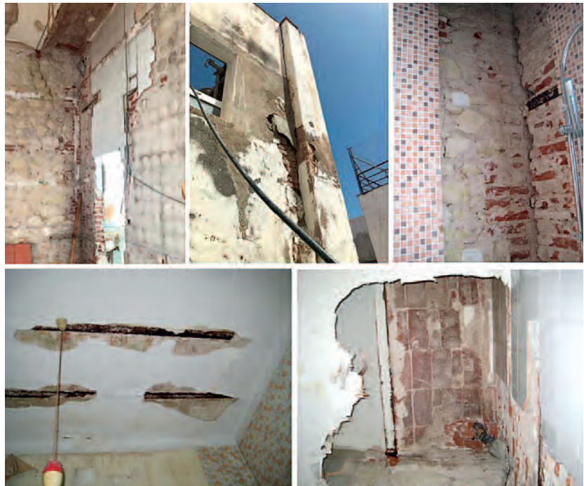
(Figura 14) Daños en forjados y medianeras.
