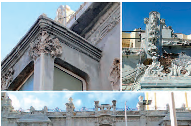
(Figura 3) Detalles patologías en fachada.
