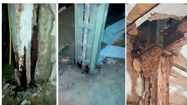
(Figura 21) Estado de pilares y rehabilitación.
