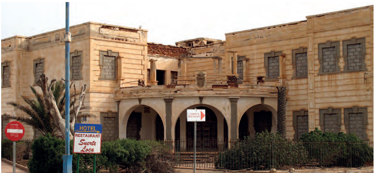
Antiguo Consulado, anteriormente sede del Gobierno, con sus ventanas cegadas y en un mal estado de conservación.
