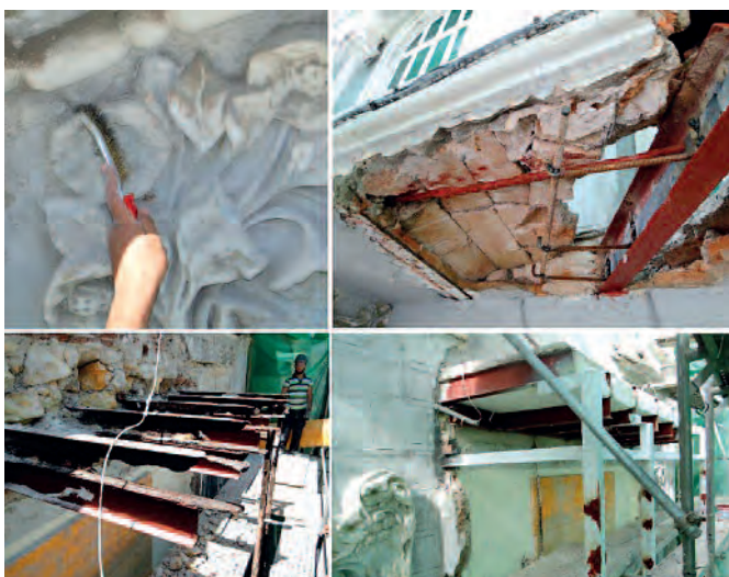
(Figura 4) Patologías y refuerzos.
