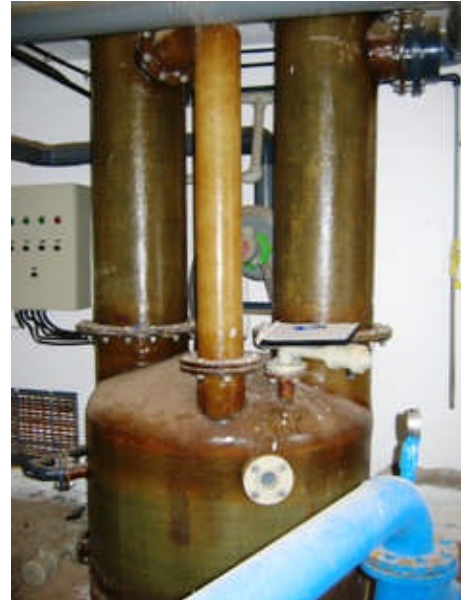
Torre de neutralización de cloro
