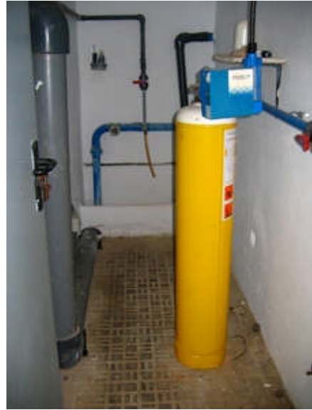
Instalación de cloración
