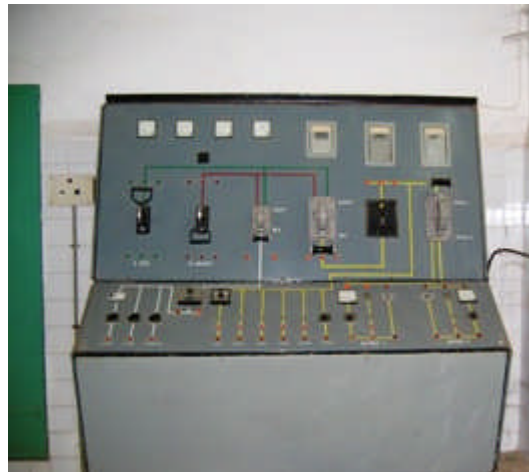
Cuadro de control
