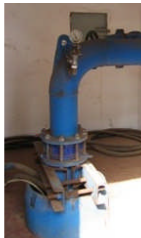
Tubería de impulsión
