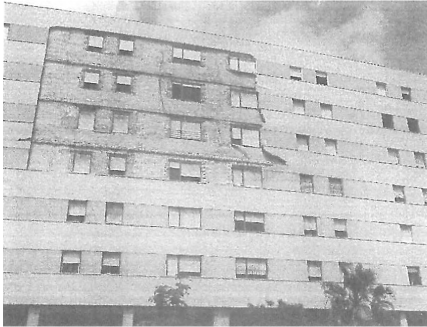
Fotografía n° 1 – Fotografía reflejada en documento de Contratación de Informe Pericial aportado del desplome de la fachada.
