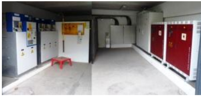
Centro de transformación
